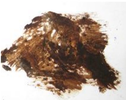
Abbildung 13 : in Rohre befundenen schleimartigen Biofilm
