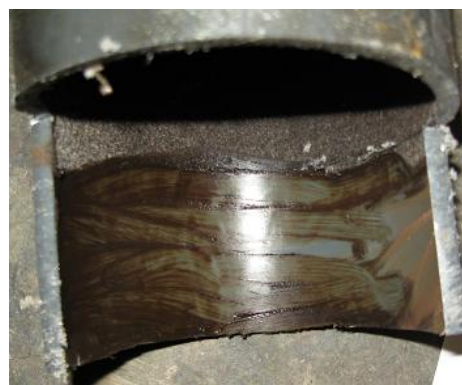
Abbildung 14 : erkennbarer schleimartiger Biofilm in der Hauptleitung
