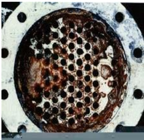
Biofilm im Wärmetauscher
