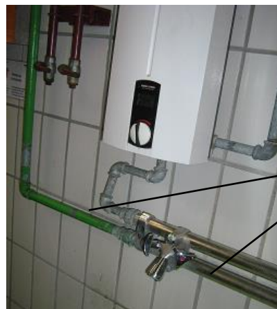
Abbildung 6: verzinkte und Edelstahlrohre mit Durchlauferhitzer
