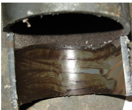
Abbildung 14: erkennbarer schleimartiger Biofilm in der Hauptleitung
