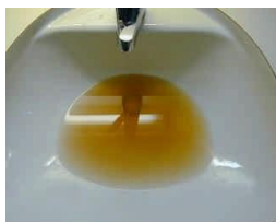
Rost in der Anlage
