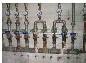
Ursache: schlecht gewartete Trinkwasseranlagen
