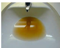
Rost in der Anlage
